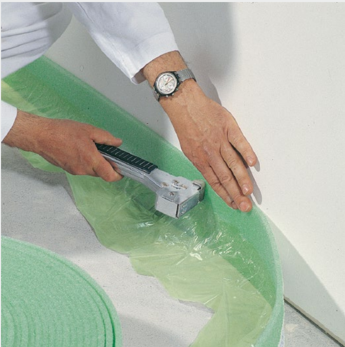
Randdämmstreifen mit Folie anbringen (auch an Rohren, Heizungsständen u. Ä.), nicht in Höhe des Estrichs klammern!
