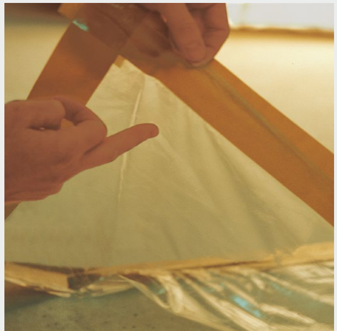
Kontrolle auf Kondenswasserbildung unter der Folie
