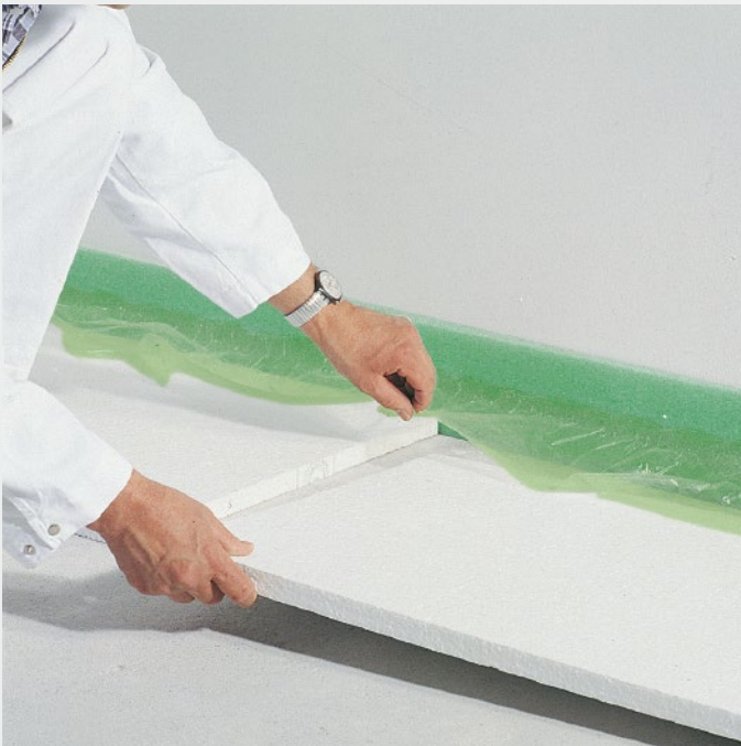
EPS-Dämmung unter die Folie des Randdämmstreifens schieben und Reihe für Reihe im Verband verlegen
